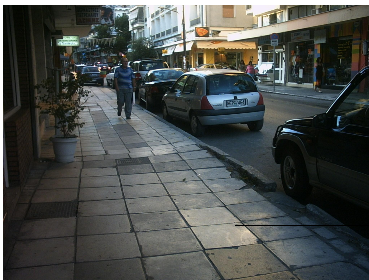
ΟΔΟΣ Λ.ΠΑΠΑΠΑΥΛΟΥ, ΚΑΚΟΤΕΧΝΙΑ ΣΕ ΠΕΖΟΔΡΟΜΙΟ, ΔΙΑΦΟΡΕΤΙΚΑ ΕΠΙΠΕΔΑ ΣΕ ΠΕΖΟΔΡΟΜΙΟ (Α08)
