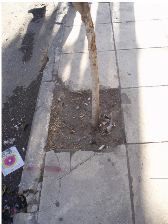
ΟΔΟΣ ΜΕΡΑΡΧΙΑΣ, ΚΑΚΟΤΕΧΝΙΑ ΣΕ ΠΕΖΟΔΡΟΜΙΟ (Α01)
