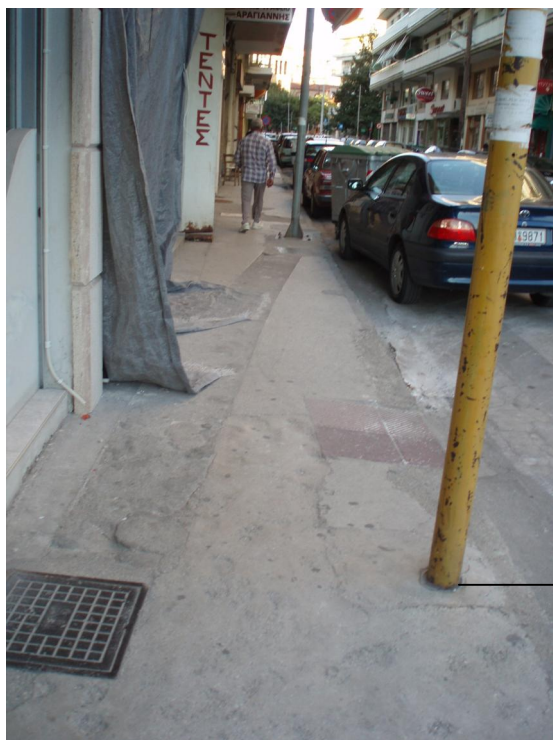
ΔΙΑΣΤΑΥΡΩΣΗ ΟΔΩΝ ΘΕΣΣΑΛΟΝΙΚΗΣ ΜΕ Γ.ΠΑΠΑΝΔΡΕΟΥ ΚΑΚΟΤΕΧΝΙΑ ΣΕ ΠΕΖΟΔΡΟΜΙΟ - ΑΝΕΠΑΡΚΗΣ ΠΛΑΚΟΣΤΡΩΣΗ (Α04)
