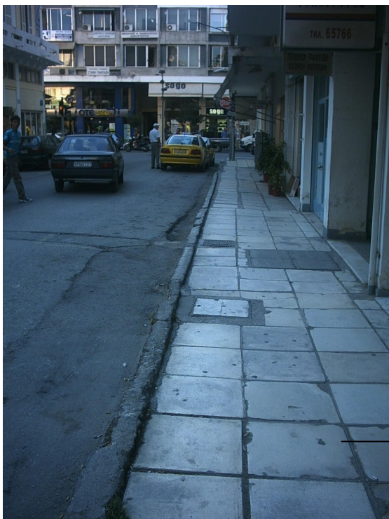
ΟΔΟΣ ΙΟΥΣΤΙΝΙΑΝΟΥ, ΚΑΚΟΤΕΧΝΙΑ ΣΕ ΠΕΖΟΔΡΟΜΙΟ, ΔΙΑΦΟΡΕΤΙΚΑ ΕΠΙΠΕΔΑ ΣΕ ΠΕΖΟΔΡΟΜΙΟ (Α07)
