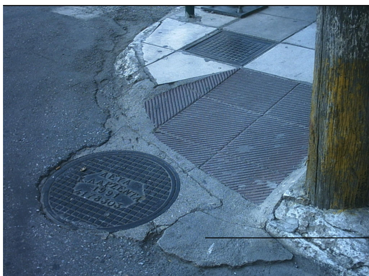
ΔΙΑΣΤΑΥΡΩΣΗ ΟΔΩΝ ΜΕΡΑΡΧΙΑΣ ΚΑΙ ΘΕΣΣΑΛΟΝΙΚΗΣ ΚΑΚΟΤΕΧΝΙΑ ΣΕ ΔΡΟΜΟ (B02)
